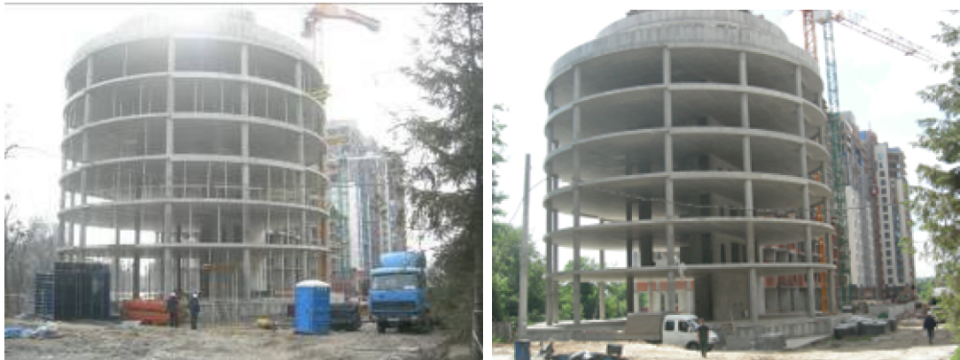
Рисунок 1.1. Хід робіт з будівництва ж/б 1 по вул. Професора Підвисоцького у Печерському районі м. Києва станом (зліва-направо): на 12.03.2009 р. та на 18.06.2009 р.
