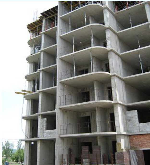
Хід будівництва житлового будинку на розі бульвару Шкільного та проспекту Миру в м. Донецьку станом на початок 2010 року
