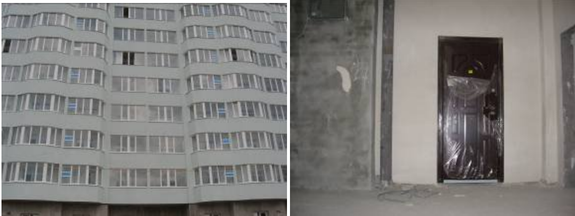
Стан будівництва 2-х житлових будинків по вул. Рєпіна, 19 у м. Севастополі станом на березень 2009 р.
