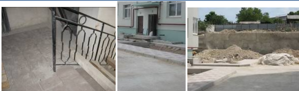
Стан будівництва 2-х житлових будинків по вул. Рєпіна, 19 у м. Севастополі станом на червень 2009 р.
