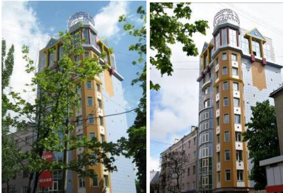
Житловий будинок по вул. Артема, 90 в у м. Донецьку станом на 29.05.2009 р. та станом на вересень 2009 р.
