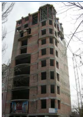
Рисунок 2.5. Хід робіт на об'єкті будівництва по вул. Артема у м. Донецьку станом на 21.02.2008 р.
