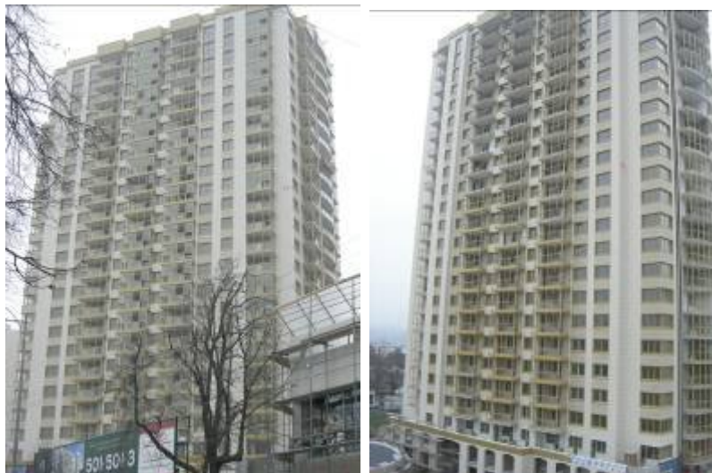
Хід будівництва житлового комплексу «Парк Авеню» (I черга) станом на 03.12.2009 р. (зліва-направо): будинок № 1 та будинок № 2
