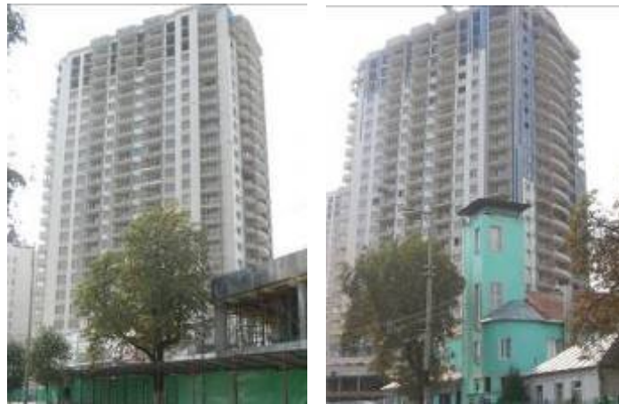
Хід будівництва житлового комплексу «Парк Авеню» (I черга) станом на 15.09.2009 р. (зліва-направо): будинок № 1 та будинок № 2
