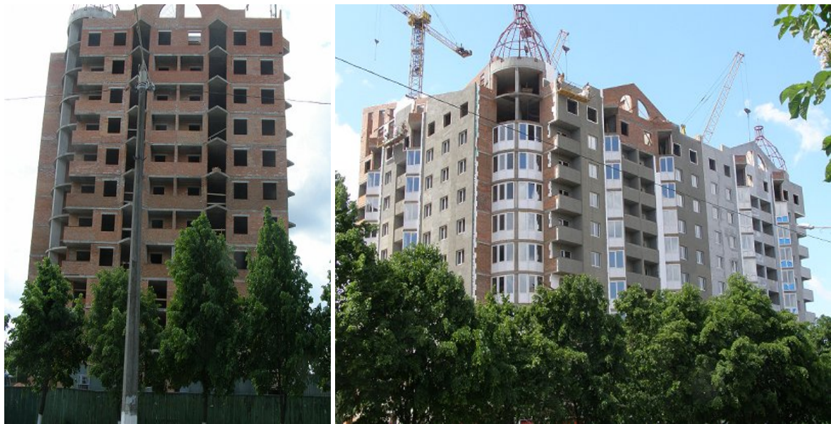
Хід виконання будівельних робіт житлового мікрорайону по просп. Шевченка, 2 (зліва-направо: I та II черги) у м. Вишгороді станом на 15.05.2009 року
