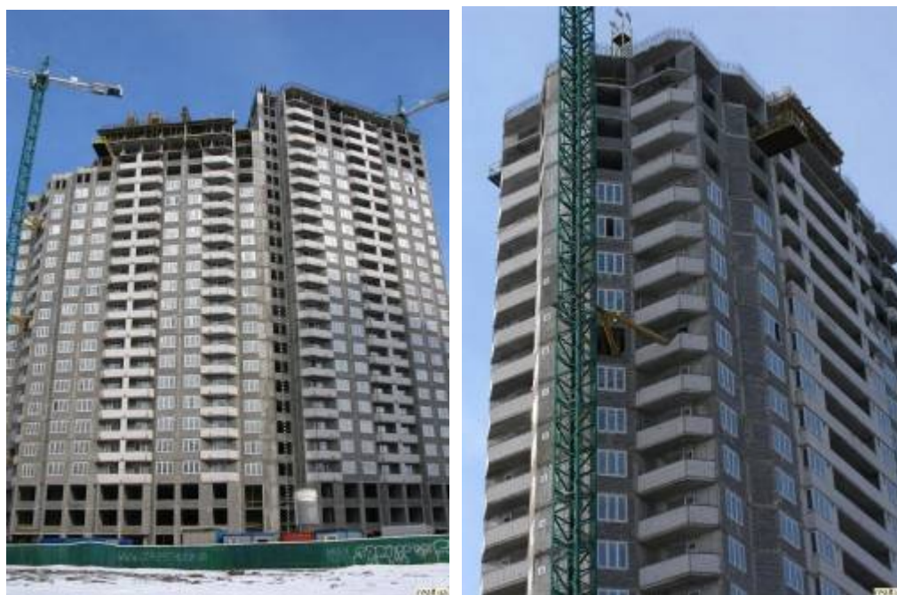
Рисунок 2. Стан будівництва житлового будинку по вул. О. Пчілки у 4-му м/н ж/м Позняки на березень 2010 р.
