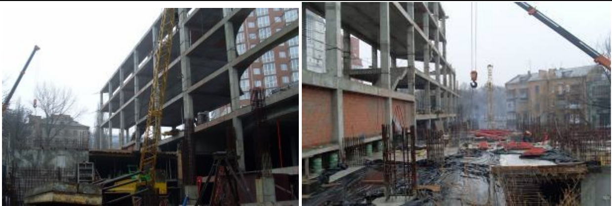
Рисунок 2.2. Стан реалізації інвестиційно-будівельного проекту у кварталі, що обмежений пр. Пушкіна – пров. Ушинського – вул. Щорса – вул. Херсонською, м. Дніпропетровськ, станом на початок лютого 2009 р.
