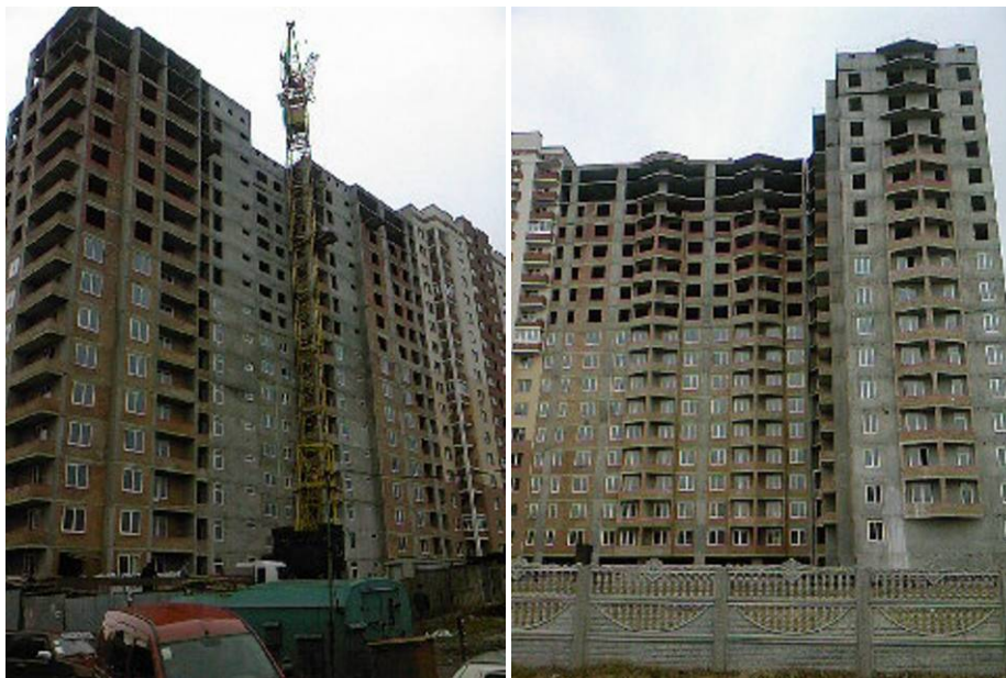
Хід будівництва багатопверхового житлового будинку з вбудованими офісними приміщеннями та підземними автостоянками по вул. Панча, 18-б у м. Львові станом на середину лютого 2009 року
