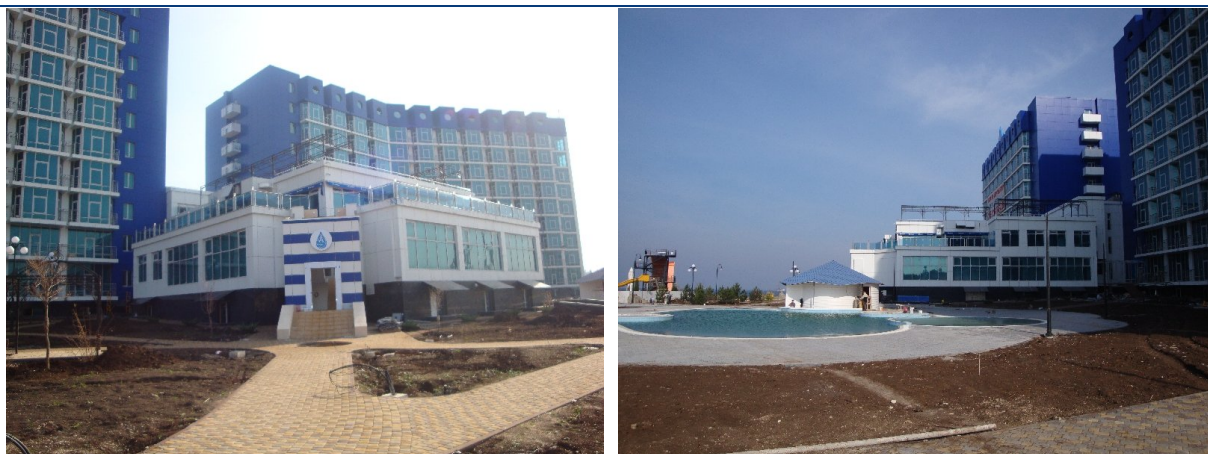
Рисунок 1. Хід робіт на об'єкті будівництва у парку Перемоги в м. Севастополі станом на початок листопада 2010 року
