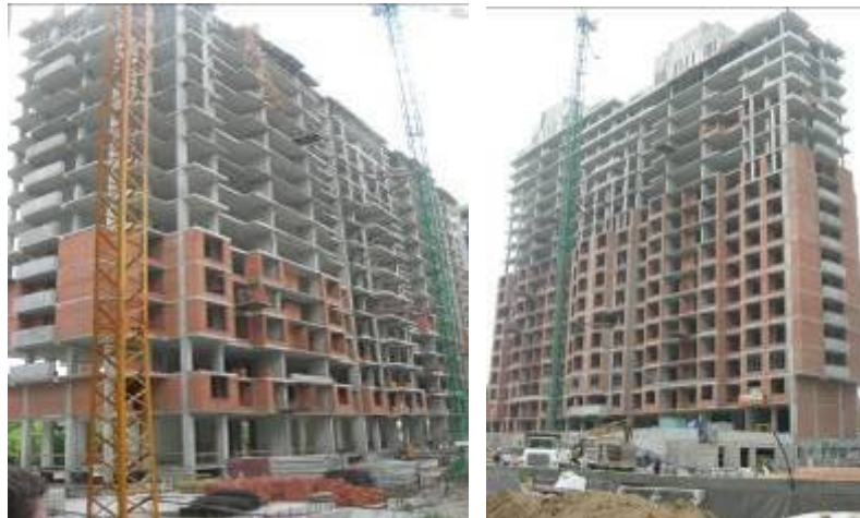
Хід робіт з будівництва ж/б 2 по вул. Професора Підвисоцького у Печерському районі м. Києва станом (зліва-направо): на 18.06.2009 р. та на 03.09.2009 р.
