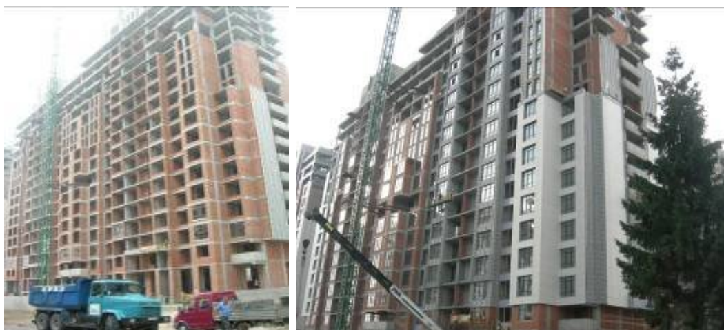
Хід робіт з будівництва ж/б 4 по вул. Професора Підвисоцького у Печерському районі м. Києва станом (зліва-направо): на 03.09.2009 р. та на 19.11.2009 р.
