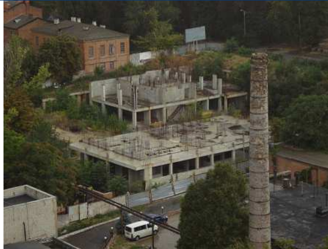
Об'єкт незавершеного будівництва по вул. Фурманова, 11 у м. Дніпропетровську, станом на початок серпня 2013 року
