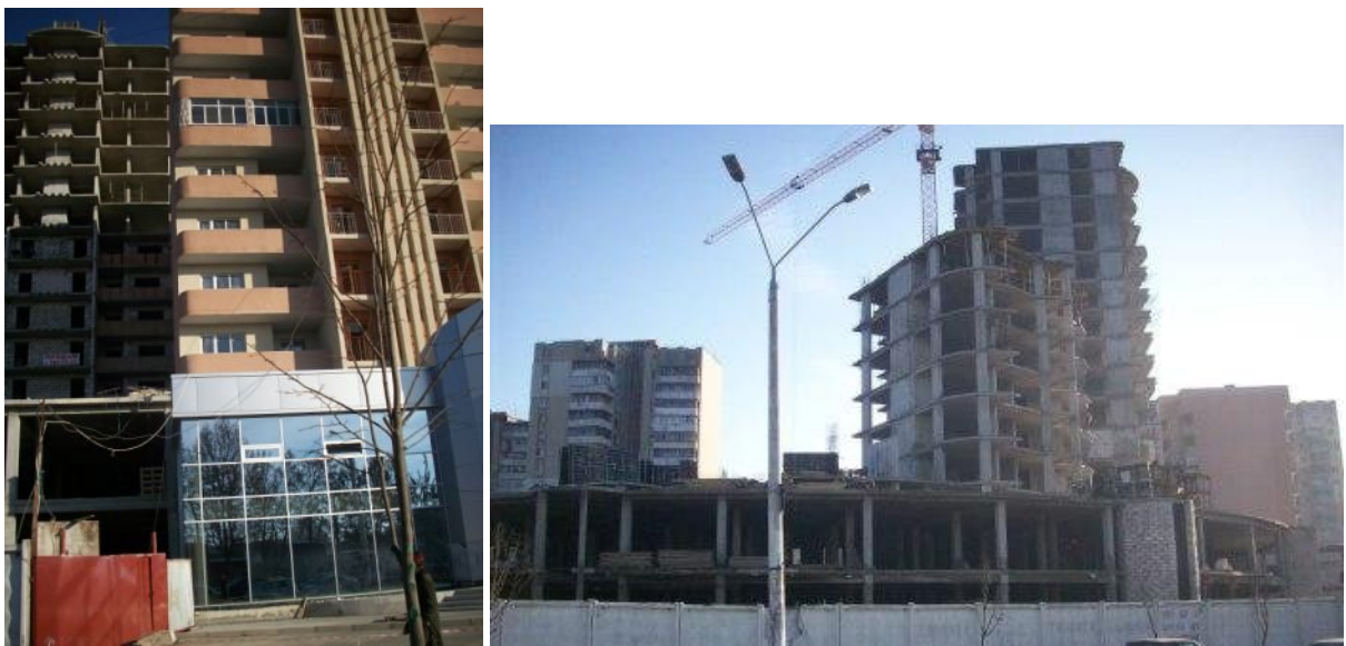
Рисунок 2. Стан будівництва громадсько-житлового комплексу у мікрорайоні ім. Таїрова на розі вул. 25-ї Чапаївської дивізії та просп. Маршала Жукова у м. Одесі на початок 2010 р.
