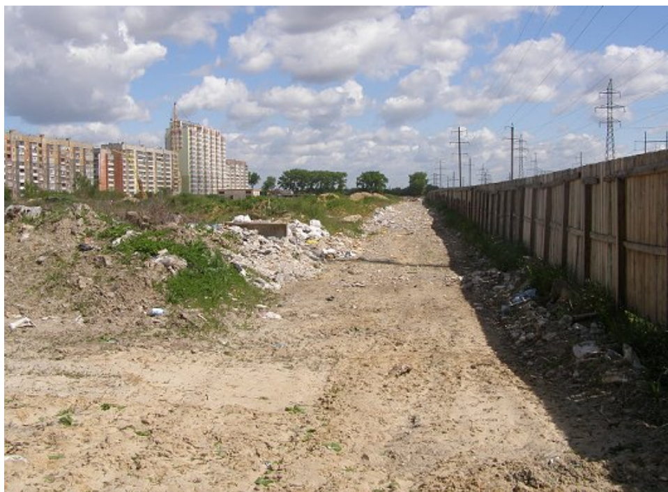
Хід робіт на об'єкті будівництва (II черга забудови кварталу Олімпійський) у м. Броварах Київської обл. станом на 14.05.2009 р.
