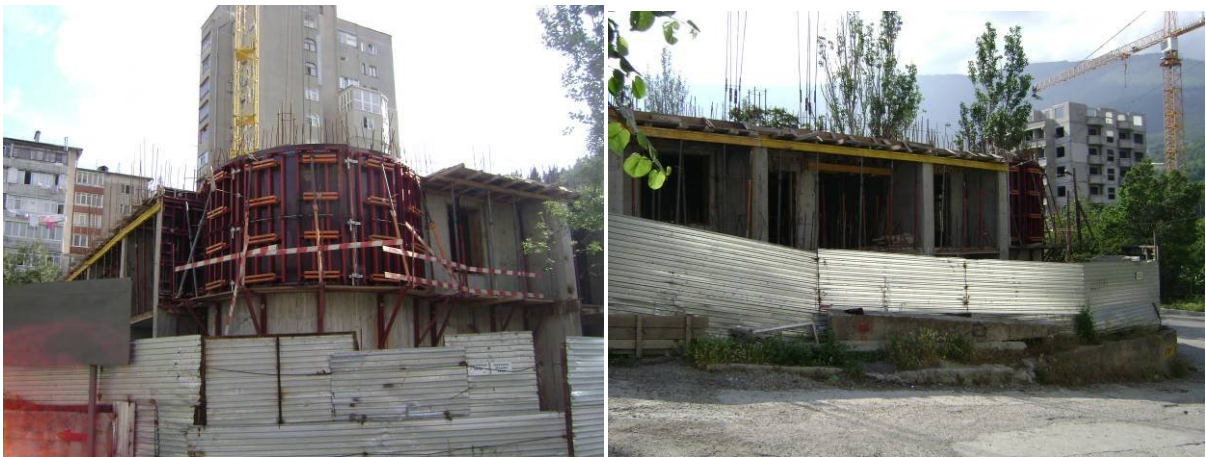
Будівельні роботи по вул. Грибоєдова в районі будинку №13 у м. Ялті станом на 09.06.2009 р.
