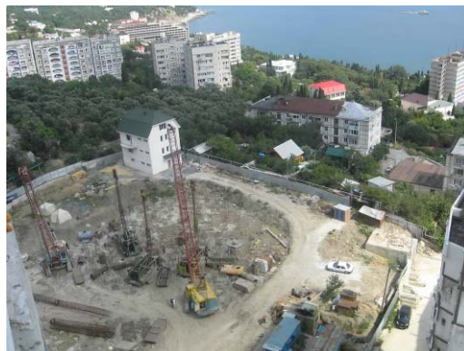
Рисунок Ошибка! Текст указанного стиля в документе отсутствует..4. Стан робіт на об'єкті будівництва по вул. Южній, 64-66 (II черга), станом на кінець березня 2009 року
