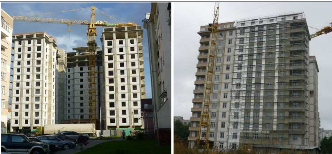
Хід будівництва багатопверхового житлового будинку з вбудованими офісними приміщеннями та підземними автостоянками на пр. В. Чорновола – вул. П. Панча в м. Львові станом на початок травня 2012 року та початок вересня 2012 року (зліва направо)
