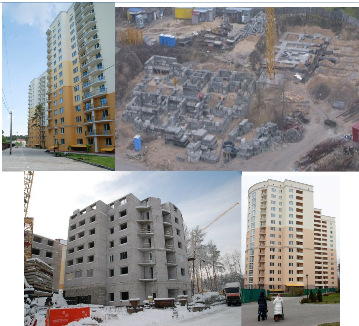
Будівництво житлового комплексу (II черга) по вул. Лобановського, 1 у с. Чайці Києво-Святошинського району Київської області станом на початок 2012 року: будинки № 6, 7, 8, 9, 10 (зліва направо)
