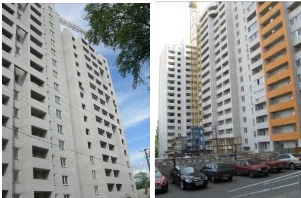
Об'єкт по вул. Дмитра Кедріна, в районі будинку №55, м. Дніпропетровськ станом на кінець травня 2009 року та на вересень 2009 року.
