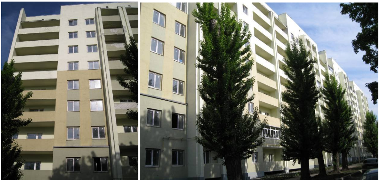
Хід робіт на об'єкті будівництва (секції Є) по Салтівському шосе, 73 у м. Харкові в м. Харкові
