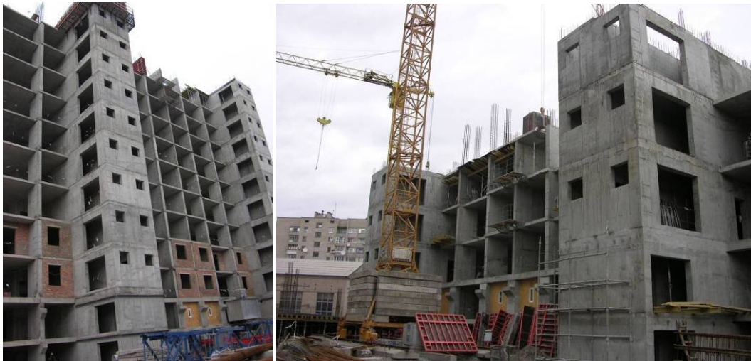
Хід робіт на об'єкті будівництва по пров. Ламаному в м. Дніпропетровську станом на 21.11.2008 р.
