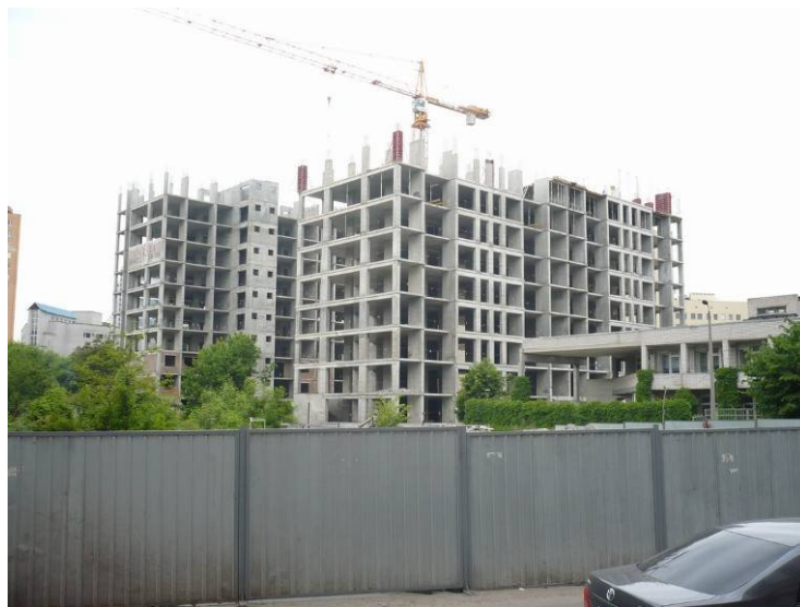
Хід робіт на об'єкті будівництва по пров. Ламаному в м. Дніпропетровську станом на 10.06.2009 р.
