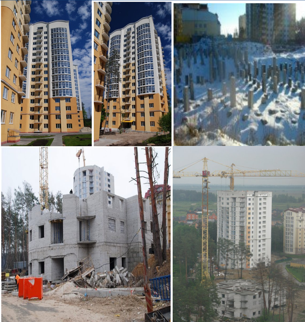
Рисунок Ошибка! Текст указанного стиля в документе отсутствует..5. Будівництво житлового комплексу (II черга) по вул. Лобановського, 1 у с. Чайці Києво-Святошинського району Київської області станом на травень 2011 року: будинки № 6, 7, 8, 9 та 10 (зліва направо)
