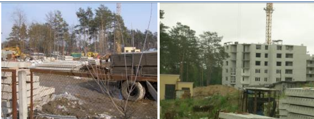
Рисунок Ошибка! Текст указанного стиля в документе отсутствует..2. Будівництво житлового комплексу (II черга) по вул. Лобановського, 1 у с. Чайці Києво-Святошинського району Київської області станом на березня та травень 2010 року
