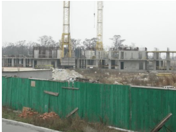
Рисунок 5. Стан будівництва житлових будинків у с. Чайці по вул. Коцюбинського, 29, 30 Київської області на 30.11.2009 р.
