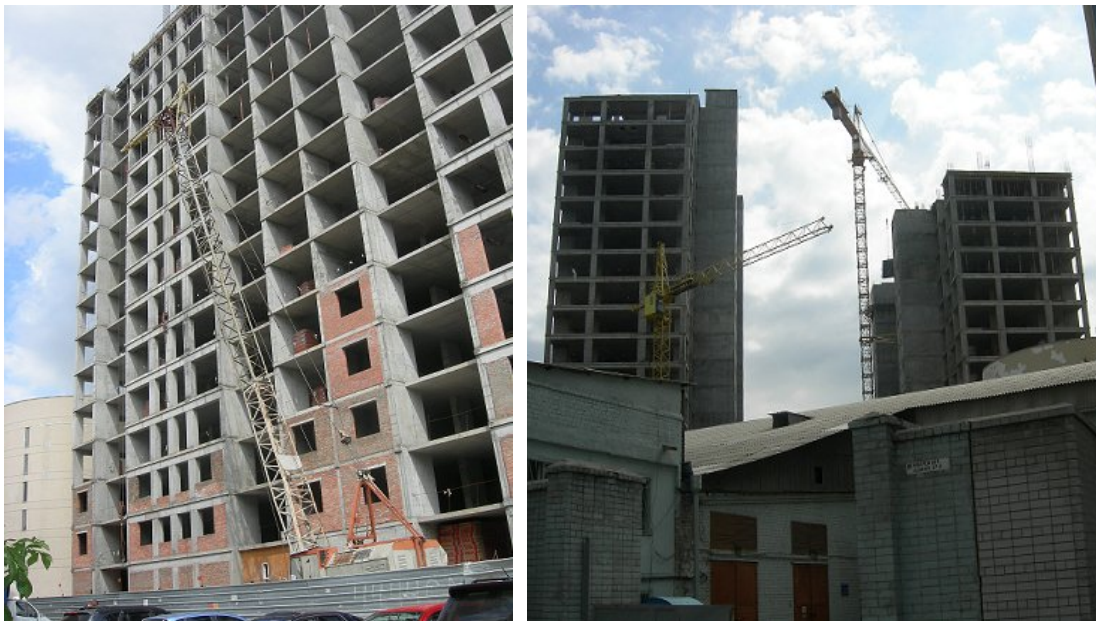
Хід робіт на об'єкті будівництва по пров. Ламаному в м. Дніпропетровську станом на початок червня 2010 року
