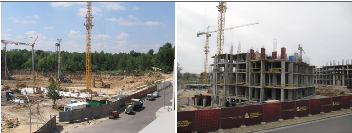
Хід будівництва другої черги житлового кварталу з об'єктами соціально-громадського призначення по вул. Професора Підвисоцького у Печерському районі м. Києва на червень та жовтень 2010 року (зліва направо)
