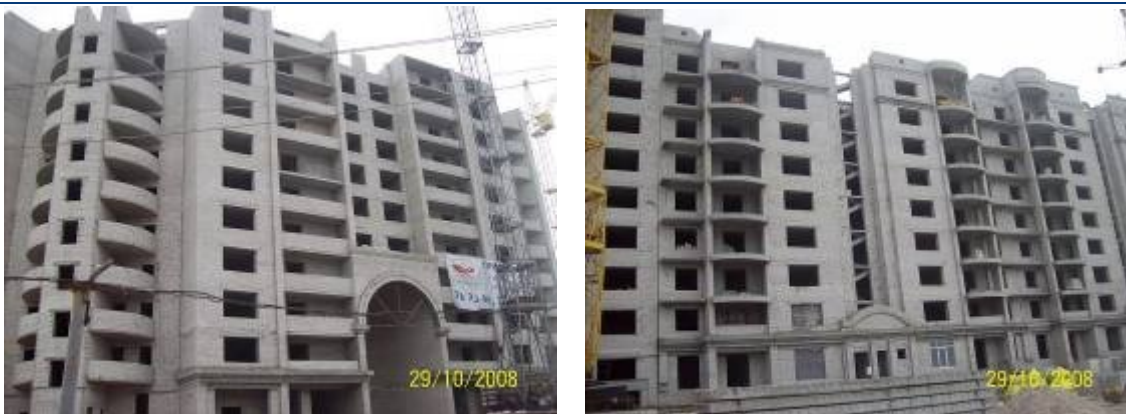
Хід будівництва мікрорайону «Ліски-2» у м. Миколаєві станом на кінець жовтня 2008 року (ж/б №№ 10 та 11)
