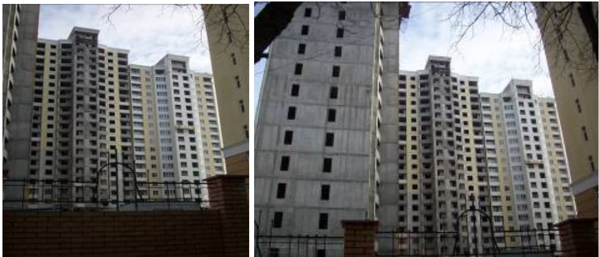
Будівництво житлового комплексу вул. Арміїській, 11 станом на 04.03.2010 р. та на кінець травня 2010 р.
