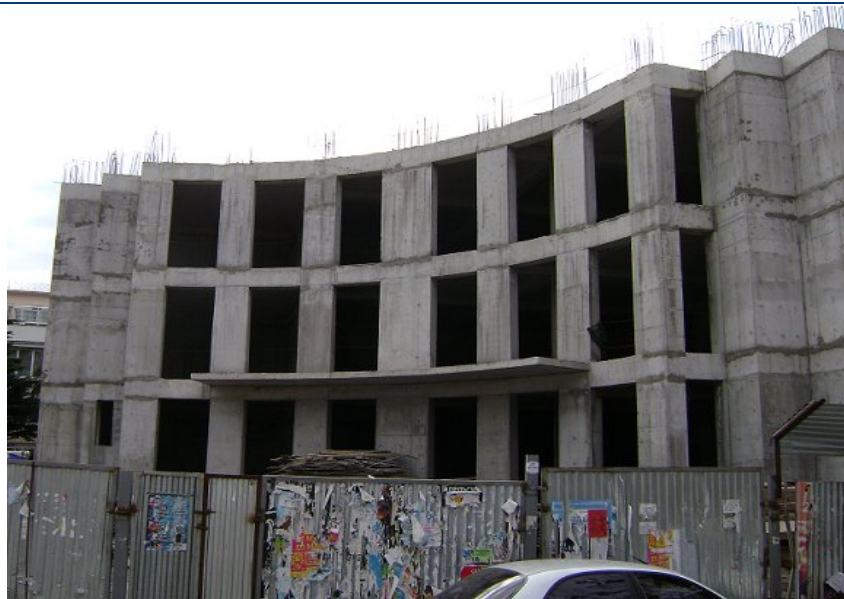
Хід робіт на об'єкті будівництва по вул. Ігнатенко, 9 у м. Ялті станом на 04.03.2010 р.
