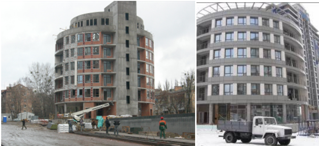
Хід робіт з будівництва ж/б 1 по вул. Професора Підвисоцького у Печерському районі м. Києва станом (зліва-направо): на 19.11.2009 р. та на 18.03.2010 р.
