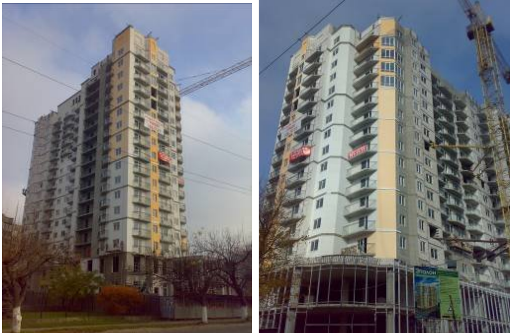
Хід робіт на об'єкті будівництва по вул. Малиновського (на розі вул. Заводської та пров. Союзного) в м. Одесі станом на кінець листопада 2010 р.
