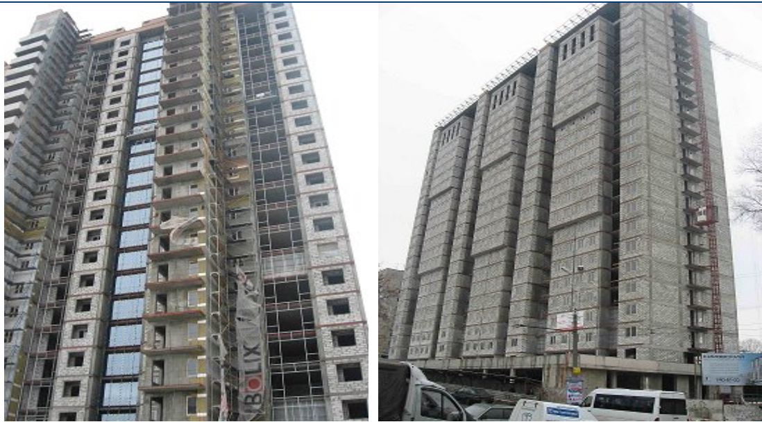
Хід робіт на об'єкті будівництва по вул. Ульянова, в районі буд. 17 А у м. Дніпропетровську станом на 10.02.2009 р.
