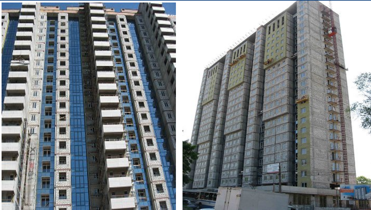
Хід робіт на об'єкті будівництва по вул. Ульянова, в районі буд. 17 А у м. Дніпропетровську станом на 20.05.2009 р.
