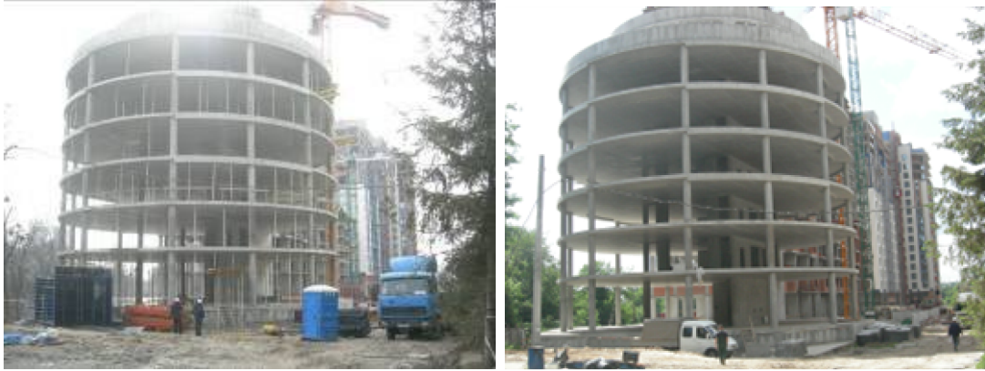
Хід робіт з будівництва ж/б 1 по вул. Професора Підвисоцького у Печерському районі м. Києва станом (зліва-направо): на 12.03.2009 р. та на 18.06.2009 р.
