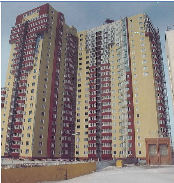
Хід робіт на об'єкті будівництва по вул. 23 Серпня (в районі буд. 31) у м. Харкові станом на кінець січня 2010 р.
