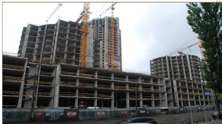
Рисунок 1.2. Будівельні роботи на об'єкті будівництва офісно-житлового комплексу в м. Києві на ділянці, обмеженої вулицями Глибочицькою, Студентською та Пимоненка станом на 01.06.2009 р.
