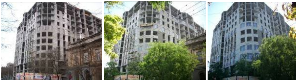
Хід будівництва житлово-торговельного комплексу по вул. Грецькій, 1 у м. Одесі станом (зліва-направо) на 20.02.2009 р., на 29.05.2009 р. та станом 08.09.2009 р.
