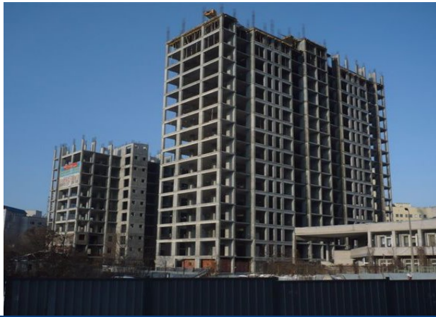
Хід робіт на об'єкті будівництва по пров. Ламаному в м. Дніпропетровську станом на 23.12.2009 р.
