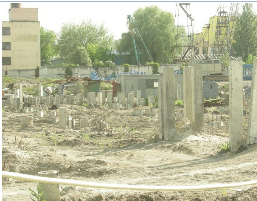
Хід робіт на об'єкті будівництва по вул. Мандриківській, 43 у м. Дніпропетровську станом на 13.05.2010 р.
