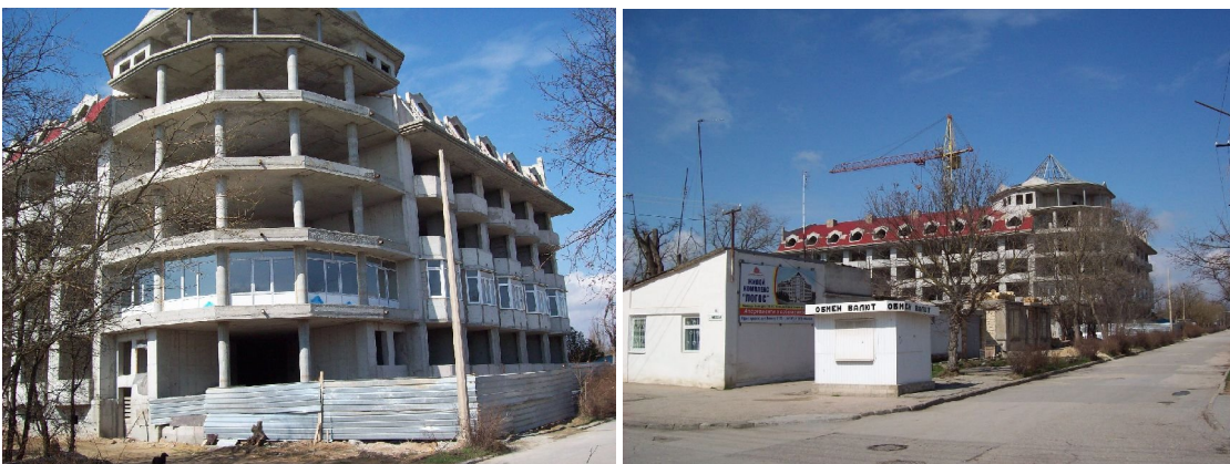
Фото будівництва Малеого готелю по вул. Франка, 11 у м. Євпаторії станом на грудень 2009 р.
