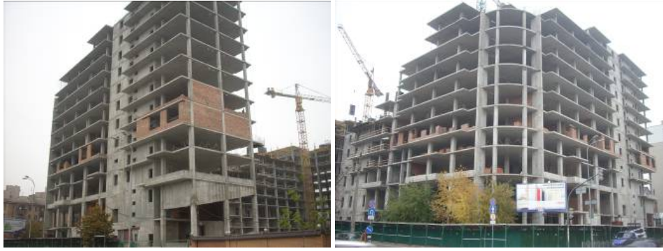
Рисунок 1.1.. Будівництво комплексу в межах вул. Боженка, 75-77, вул. Володимиро-Либідської, 21-17 та вул. Антоновича, 118 станом на кінець 2008 року
