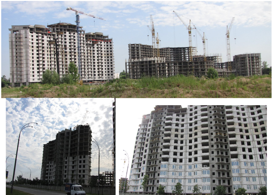
Рисунок 3.2. Стан будівництва житлових будинків з підземними паркінгами та закладів з обслуговування населення по вул. Вільямса,7 та вул. Ломоносова, 42-50 (III мікрорайон) у м. Києві на 30.06.2009 р.
