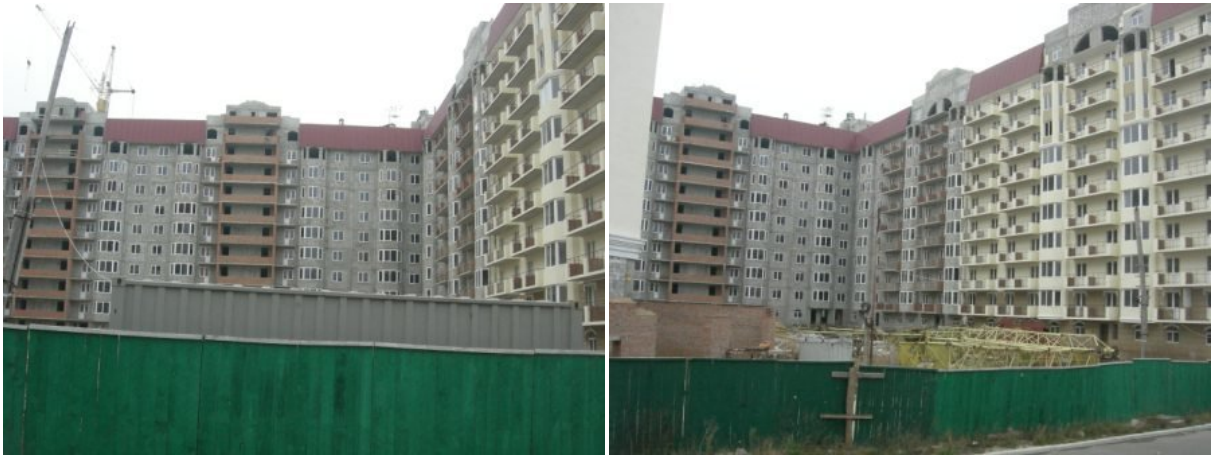
Рисунок 8. Будівництво житлового будинку у с. Чайці Київської області по вул. Коцюбинського, 9 (будівельний № 36) на 30.11.2009 р.
