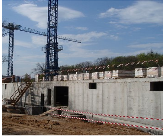
Стан будівництва житлового комплексу по вул. Фронтівій, 3 у м. Харкові станом на кінець 2009 року
