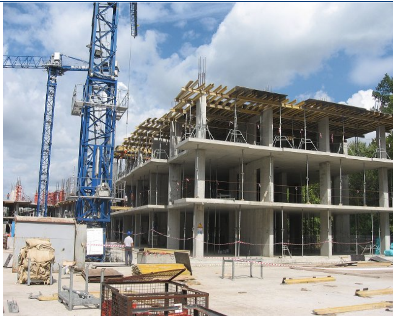
Стан будівництва житлового комплексу по вул. Фронтівій, 3 у м. Харкові станом на 20.08.2010 р.
