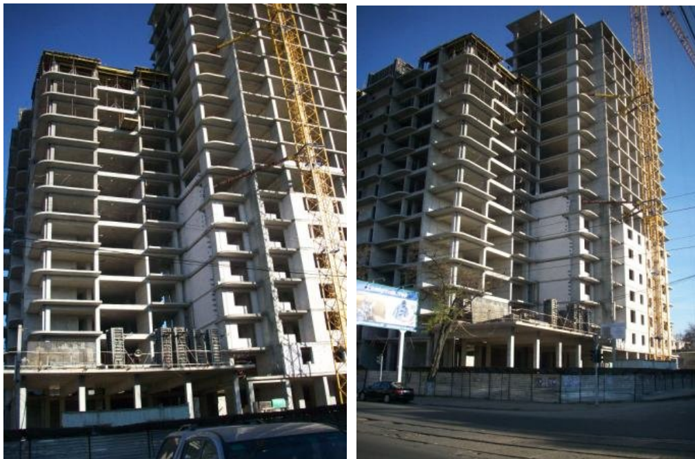
Рисунок 2. Стан будівництва житлового будинку по вул. Прохорівській, 39-41 у м. Одесі, на 26.11.2009 р.
