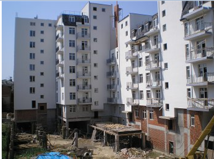
Хід будівництва групи багатоквартирних житлових будинків по вул. Червоноармійській, 43 В у м. Чернівцях станом на кінець серпня 2010 року
