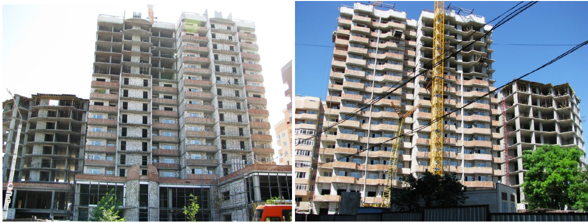
Рисунок 2. Стан будівництва громадсько-житлового комплексу у мікрорайоні ім. Таїрова на розі вул. 25-ї Чапаївської дивізії та просп. Маршала Жукова у м. Одесі станом на 18.06.2010 р.
