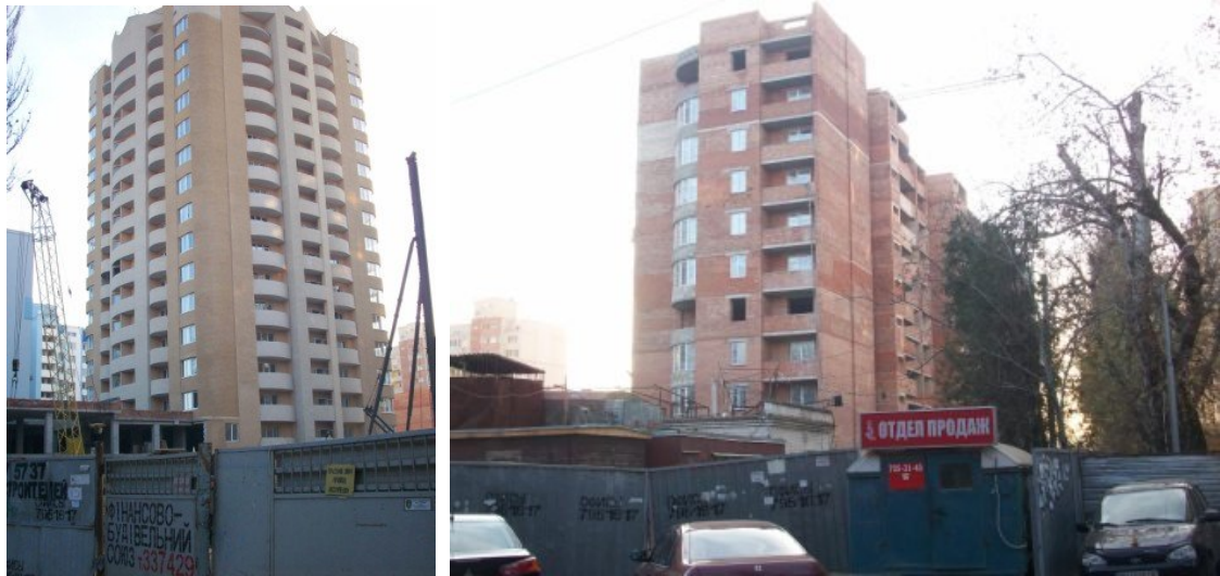
Рисунок 3. Стан будівництва громадсько-житлового комплексу по вул. М. Говорова, 10 А у м. Одесі на початок 2010 р.
