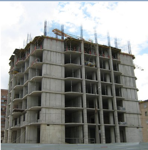
Хід будівництва житлового будинку на розі бульвару Шкільного та проспекту Миру в м. Донецьку станом на кінець 2009 року
