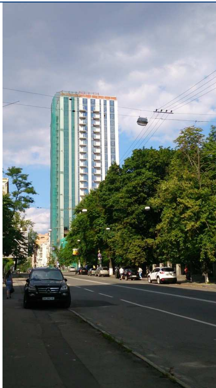
Хід будівництва житлово-офісного комплексу по вул. Воровського, 21 у м. Києві станом на 06.07.2014 р.
