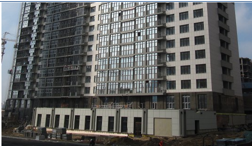
Хід будівництва магазину №17 (II черга житлового кварталу з об'єктами соціально-громадського призначення по вул. Професора Підвисоцького у Печерському районі м. Києва) станом на початок квітня 2012 року
